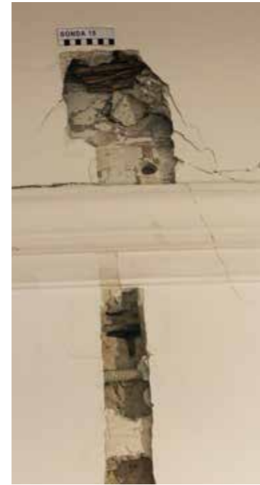
Sonda 15 iznad vrata na južnom zidu sjeverozapadnog salona u prizemlju s tragovima dekorativnih naliča koji pokazuju drukčije oblikovanje svoda prostorije
