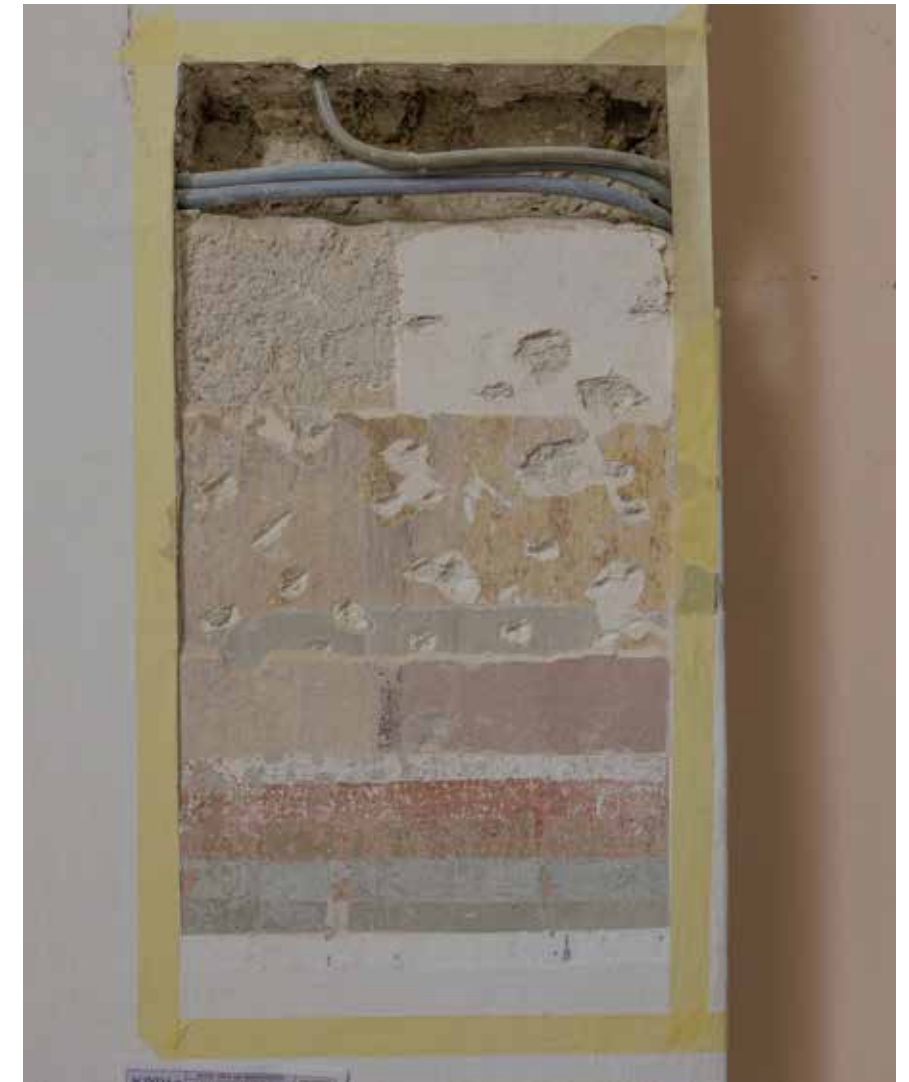
Restauratorska sonda na pilastru u svetištu sa slojevima naliča
