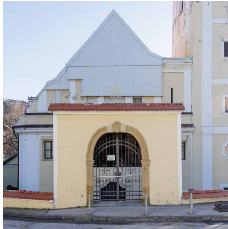
Pogled na pročelje s porušenim zabatom u potresima 2020.
