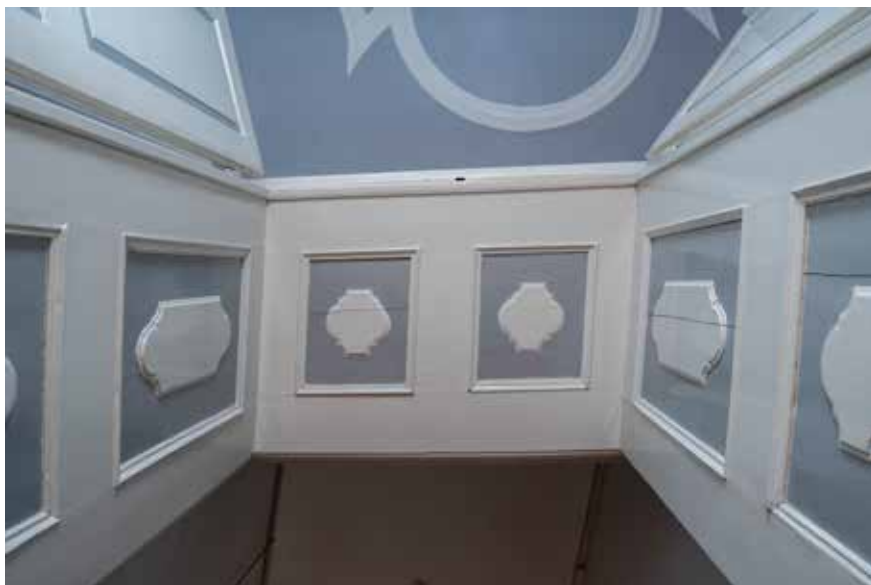
Strop prostorije na drugom katu Trške kule Drvena obloga niše vrata južnog krila
