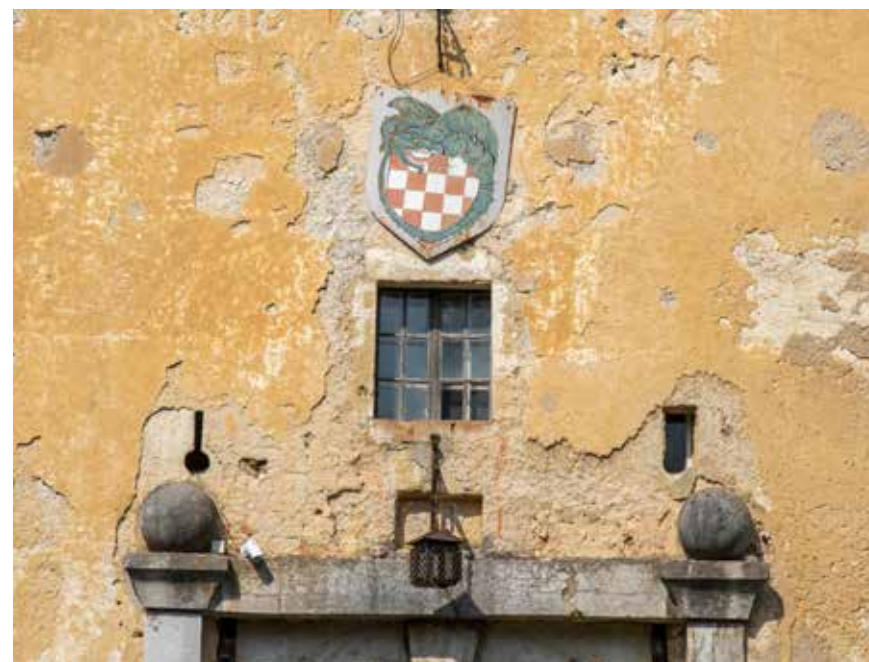
Oštećenja površine zapadnog pročelja ulazne kule i preoblikovana južna puškarnica
