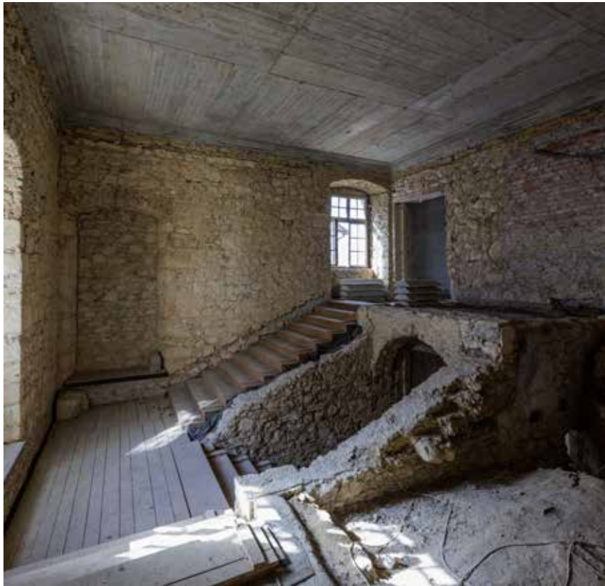
Djelomično razgrađeno trokrako stubište na drugom katu
