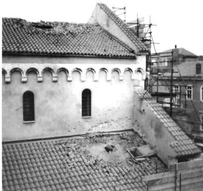
Zadar, Katedrala sv. Stošije, oštećenja na krovu (foto: P. Vežić) Zadar, St. Anastasia Cathedral, damage on the roof (photo: P. Vežić)
