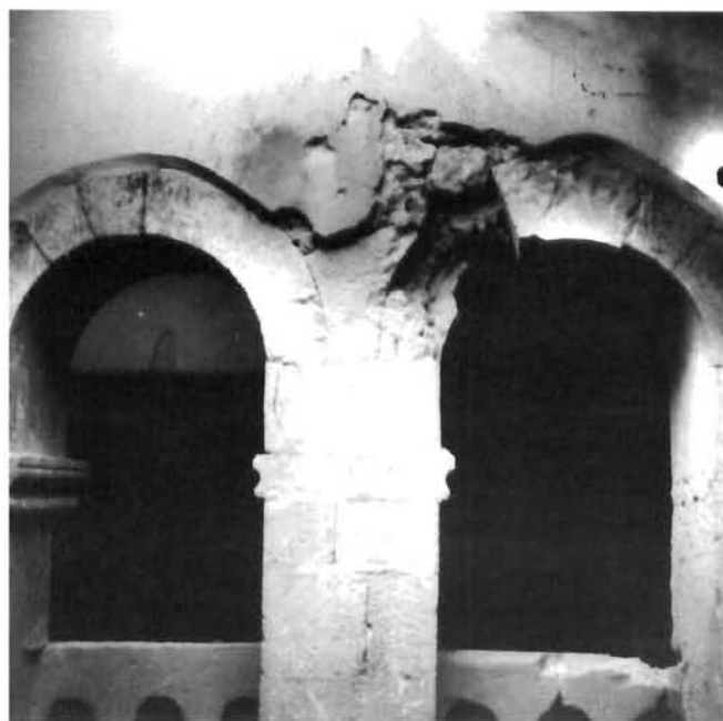
Zadar, Katedrala sv. Stošije, oštećeni lukovi na galeriji sjevernog broda (foto: P. Vežić) Zadar, St. Anastasia Cathedral, damaged arches, gallery of the north aisle (photo: P. Vežić)
