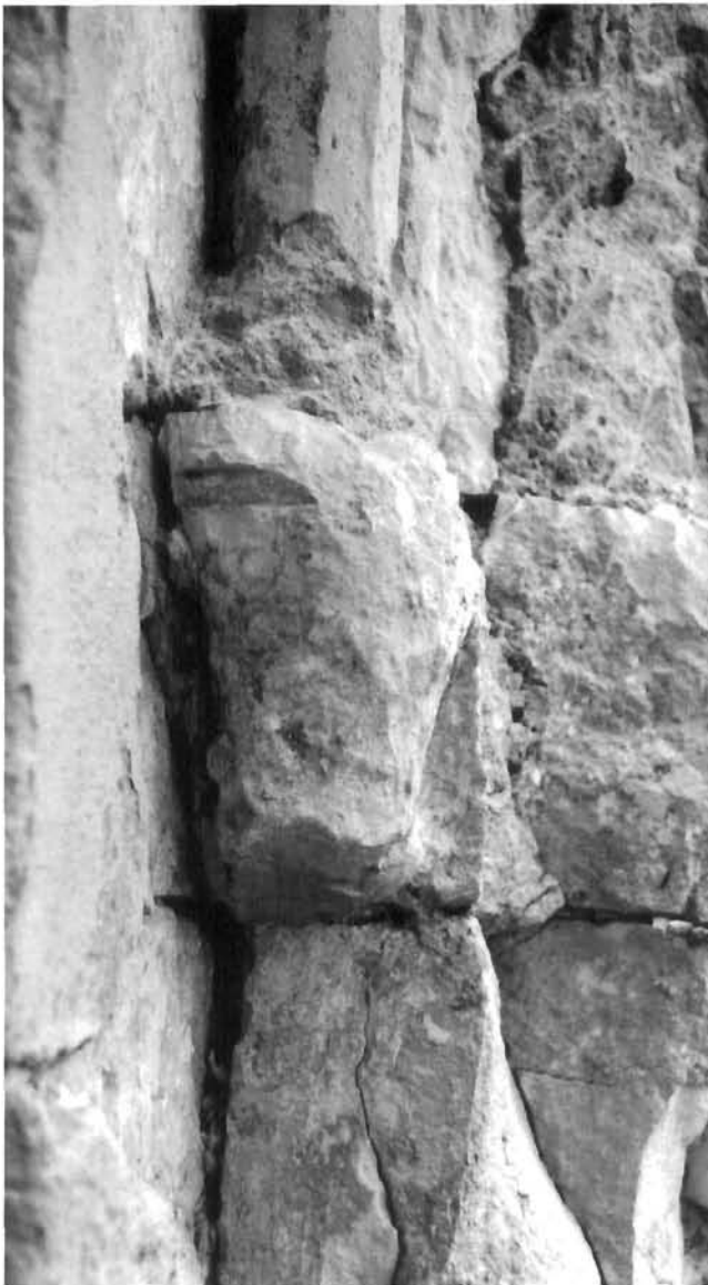
Oštećeni desni kapitel vanjskog stupića sa cvjetićem rozete u donjem uglu i s dijelom kapitelnog vijenca (foto: M. Drmić)
