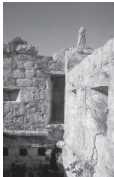
Perastijeva kula, unutrašnji zid s tragovima završne terase, ulazom u stražarnicu i topovnicama (foto: M. Renić)
