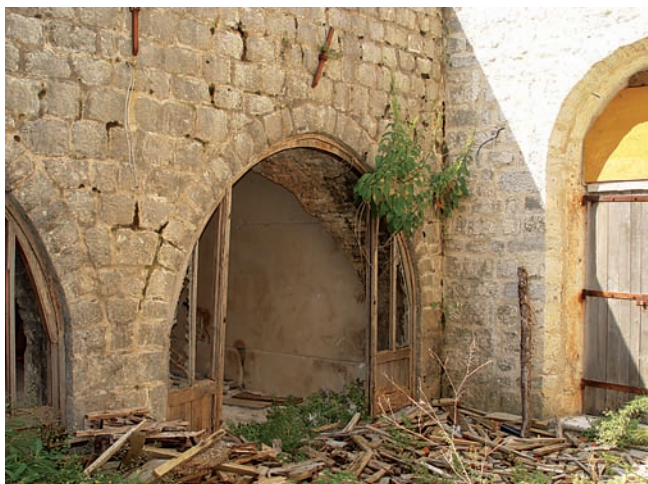
Palača Ivanović (sjeverna), lučni otvori magazina ispod terase (foto: K. Horvat-Levaj)
